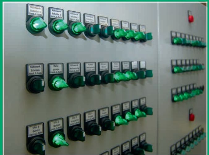
Perfekt kombiniert mit unserem Schaltschrankbau
