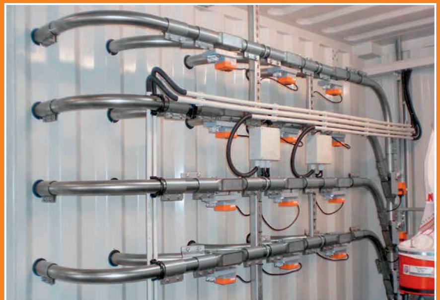
Zahlreiche Rohrleitungen und Ventile ermöglichen das arbeitswirtschaftliche Füttern vieler Teiche zur gleichen Zeit.
