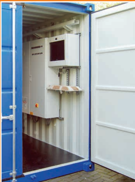
Kompakte Unterbringung der gesamten Fütterungstechnik im Container oder in vorhandenen Räumlichkeiten.
